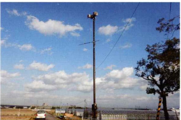
市内の防災無線アンテナ
